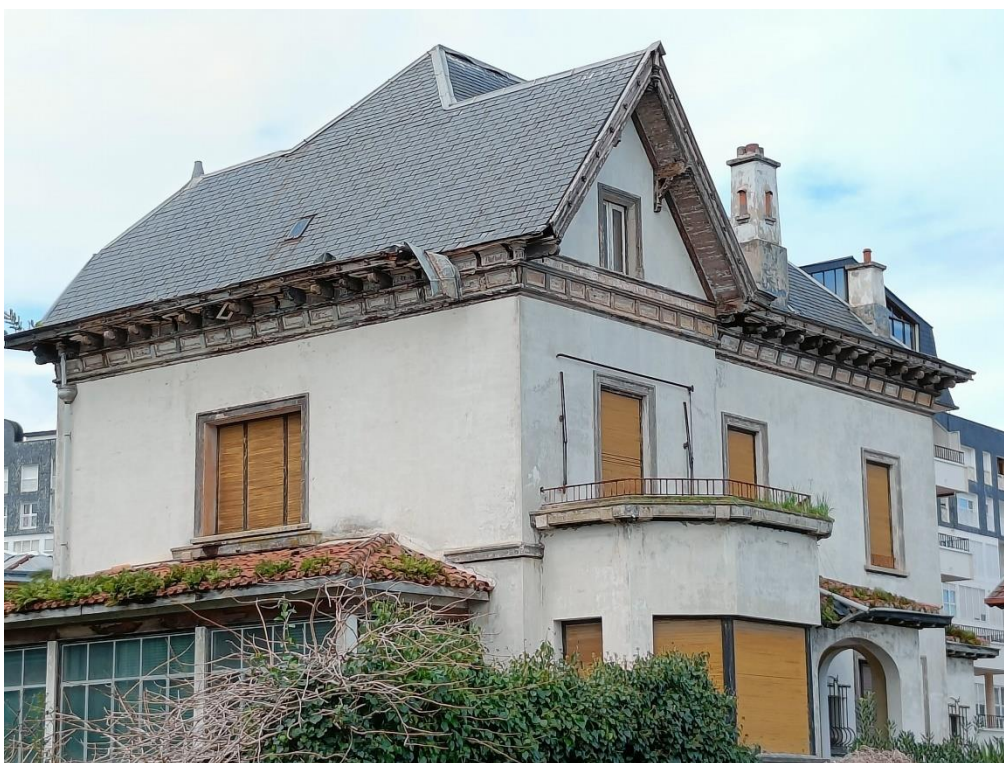
Paseo Ocharán Mazas 8. Desperfectos en el alero permiten el acceso de palomas al bajotejado.
