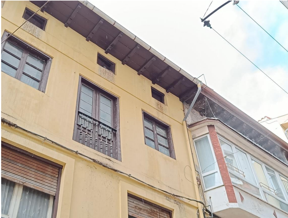
La Mar 16. Las palomas utilizan los alfeizares ensuciando toda la fachada. La instalación de una malla exterior sería una solución rápida, barata y efectiva.
