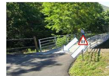
Señal vertical de doble sentido, línea divisoria de carriles en el puente, Recomendable señal horizontal de flecha indicando sentido de la circulación
