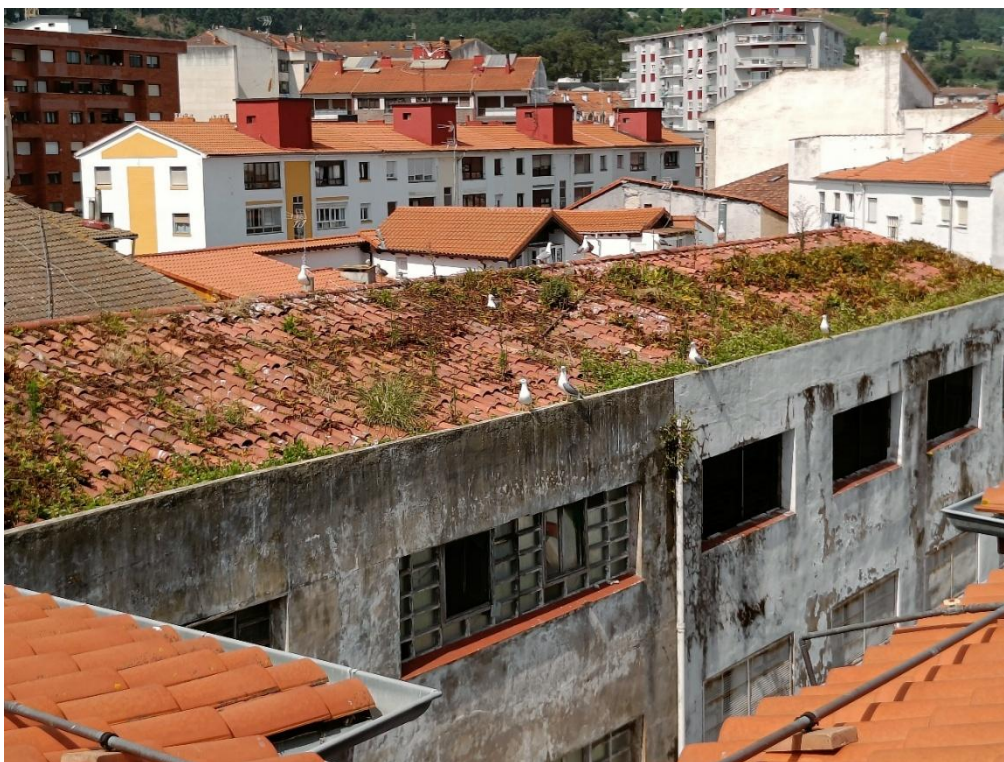
Colonia sobre nave abandonada.
