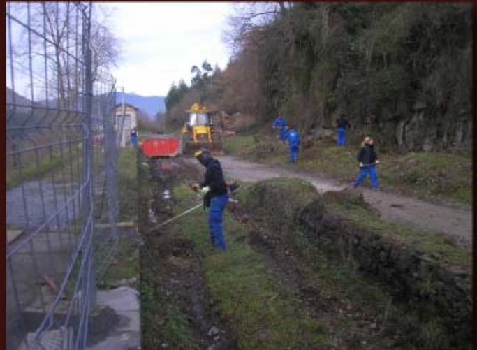
Labores de desbroce y limpieza en las inmediaciones de la Estación por parte del taller de jardinería de la escuela taller de Castro.
