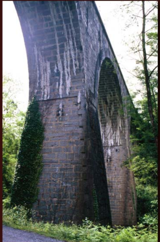
Vista del puente desde abajo. la altura sobre la carretera es de 14 m.
