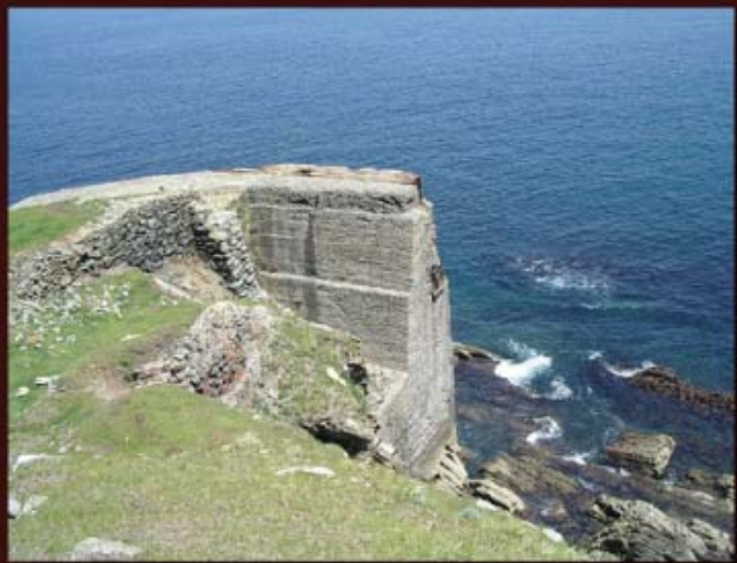
Pilastra que sostenía el cargadero
